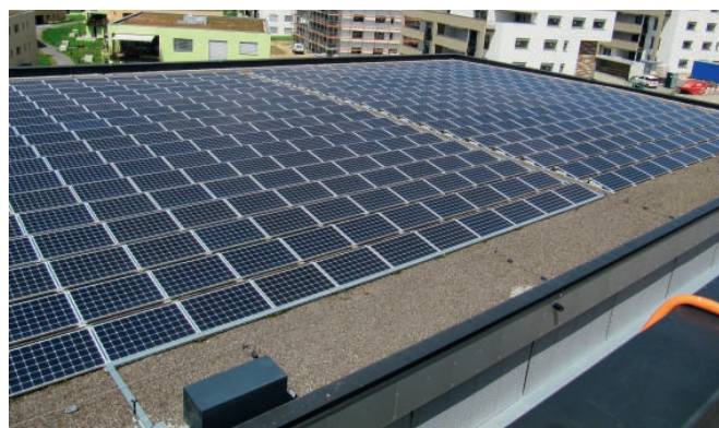
Energie Oberkirch AG: PV-Anlage auf der Dreifachsporthalle
